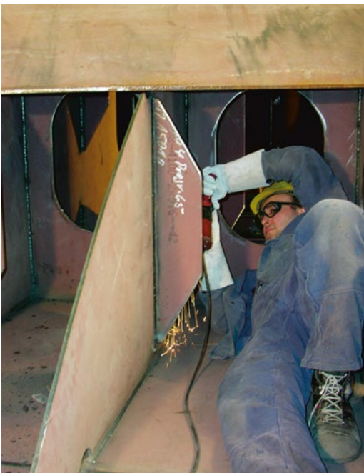
Abb. 9-1 Enger Raum mit erhöhter elektrischer Gefährdung
