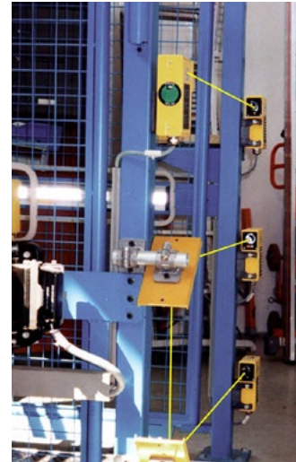
Abb. 3-7 Lichtschanke als Beispiel für eine Schutzmaßnahme Rang 2
